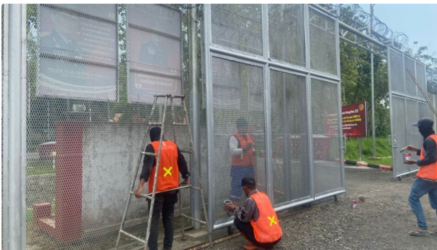
Pengecatan bangunan dan pagar Lapas Pasir Putih dalam rangka sambut HBO ke-59
